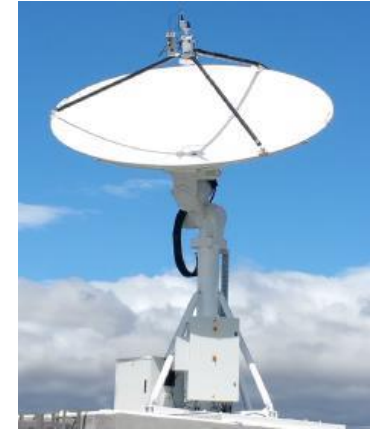
Comtech社 低軌道アンテナ設備
