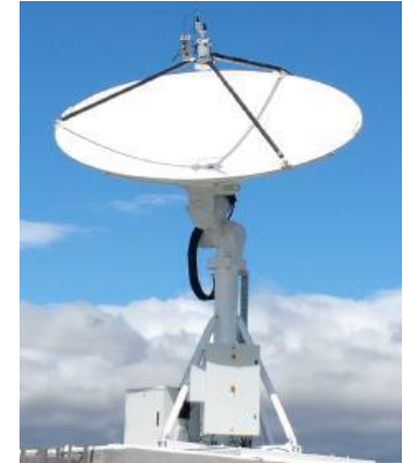
Comtech社 低軌道アンテナ設備
